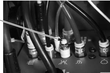
Figura 4-4 Localização da válvula do ar de lavagem do eléctrodo
