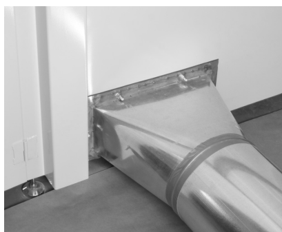
Figura 3-1 Dimensões da conexão da conduta de extracção (todas as dimensões em milímetros)
