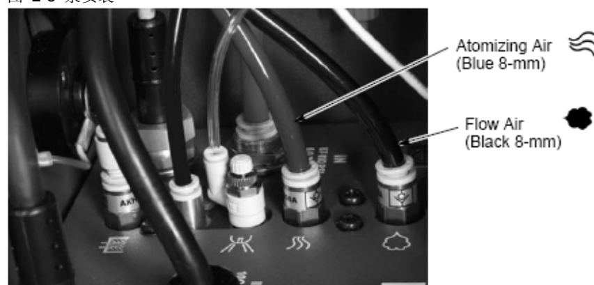
图 2-9 电源设备流动空气和雾化空气管接头
