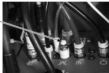
Fig. 3-3 Emplacement de la valve de lavage à l'air de l'électrode
